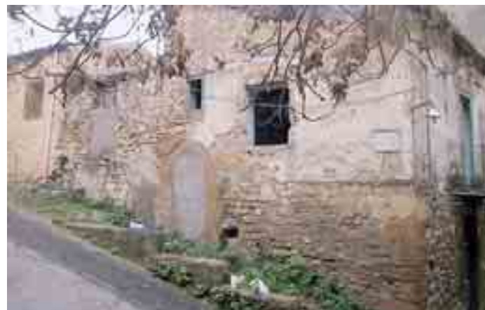
ANCORA CEDIMENTI NEL QUARTIERE PROVVIDENZA
