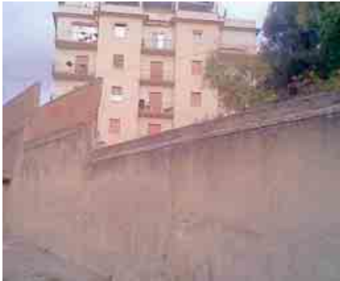
IL MURO DI CINTA DEL «PALMINTELLI» DANNEGGIATO DAL VENTO
